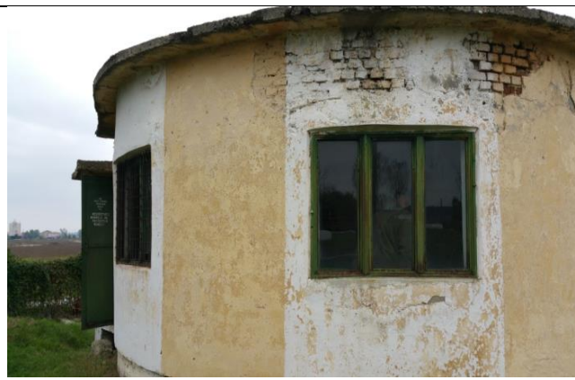
Cladire SPAU intrare Statie de Epurare
